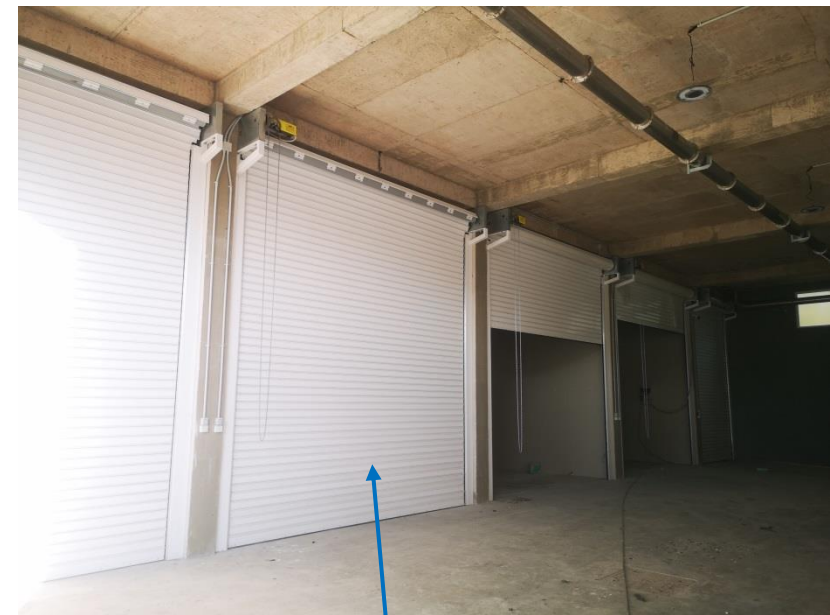
ΗΛΕΚΤΡΙΚΑ ΡΟΛΑ ΚΕΛΙΩΝ
